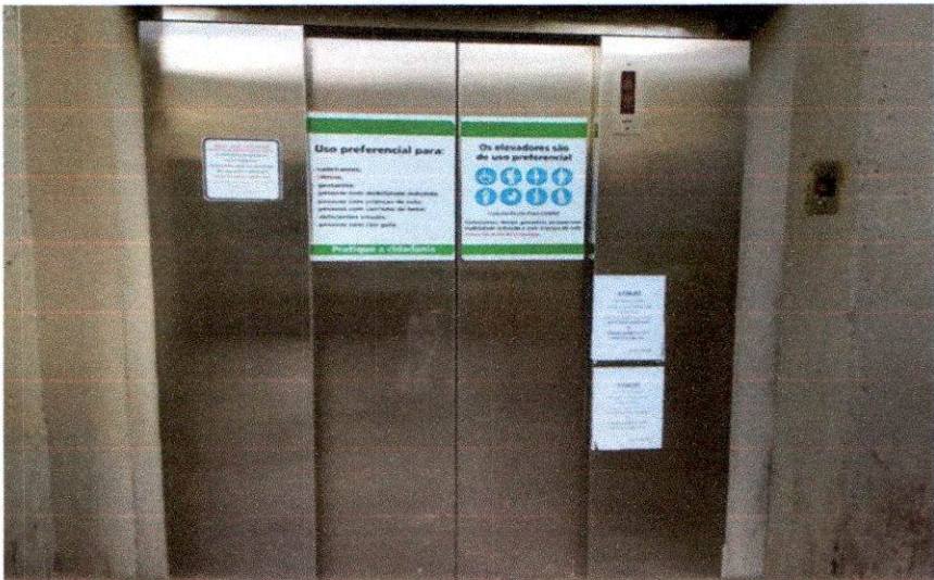
Figura 2 – Elevador da Estação de Francisco Morato
